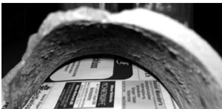
Im Bild das korrodierte Leitungsstück
