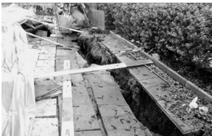
Spalte bei der oberen Liegenschaft beim Vorplatz
