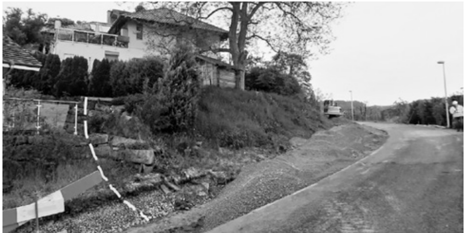
Hangabrutsch oberhalb Gempenstrasse
