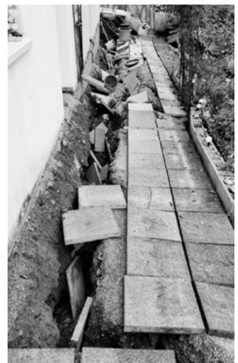
Hangabrutsch oberhalb Gempenstrasse
